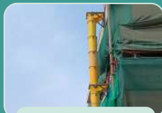
Chutes de descarga
